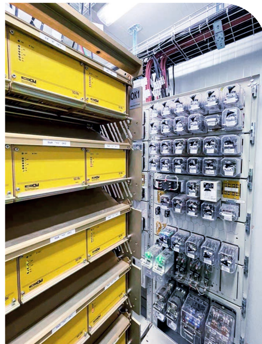
▼ Оборудование МПЦ CTRL@LOCK 400 на посту централизации станции Майлытогай КТЖ
