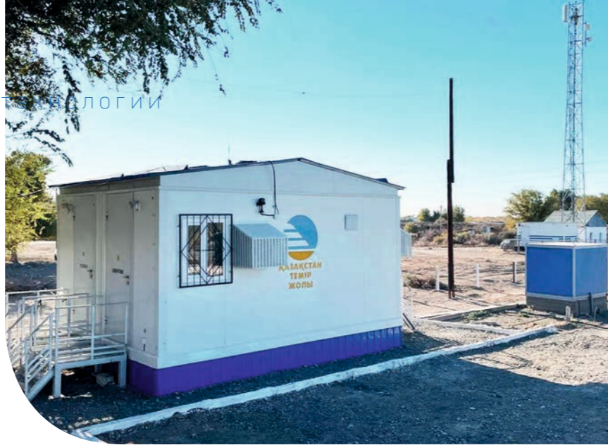
▲ Пост централизации с оборудованием МПЦ CTRL@LOCK 400
